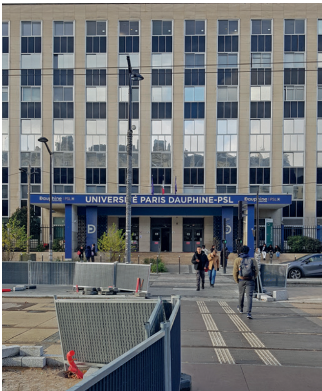
Travaux devant l'université Paris Dauphine-PSL en vue de l'arrivée du Tramway T3b prévue au printemps 2024, Paris 16 e
